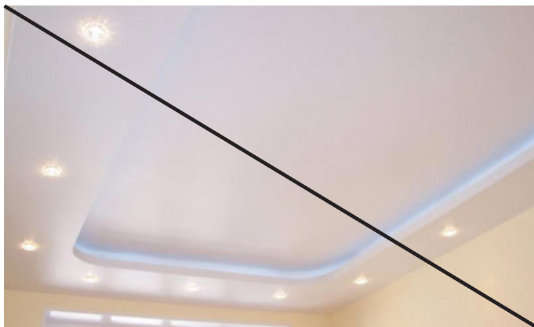
Плохо Многоуровневые гипсокартонные конструкции
